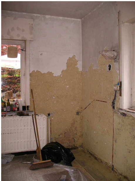
Hinter der Einbauküche waren die Wände durchfeuchtet. Bild: epasit
